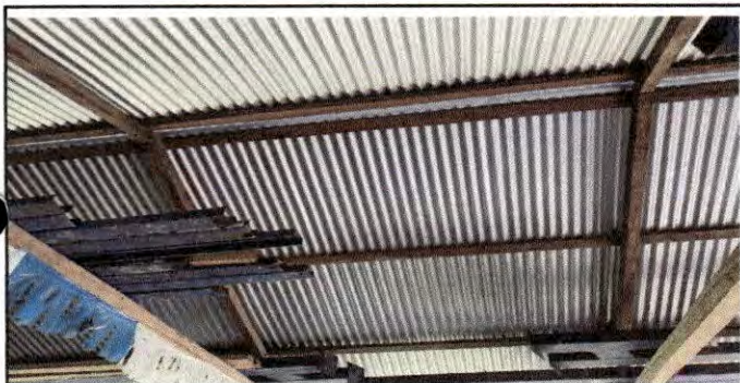
Foto 7: Estructura de madera no adecuada.
