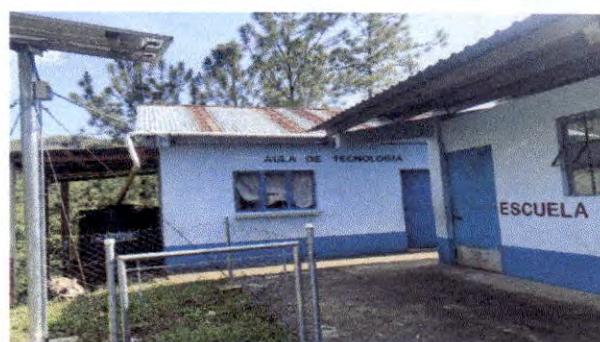
Foto 6: laminas en mal estado.
