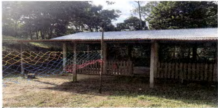
Foto 8: estructura en mal estado.
