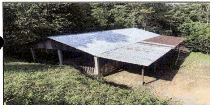
Foto 11: Lamina en mal estado por corrosión
