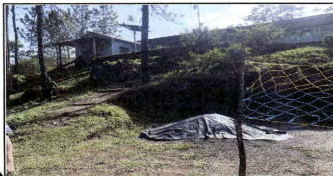
Foto 9: Patio principal sin piso de concreto.
