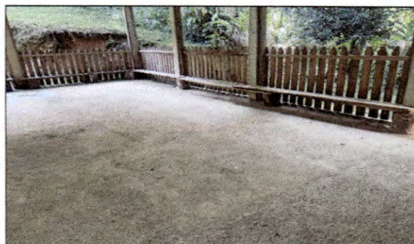
Foto 2: Piso del módulo 2 rajado.
