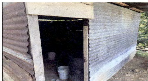
Foto 5: falta de muros .
